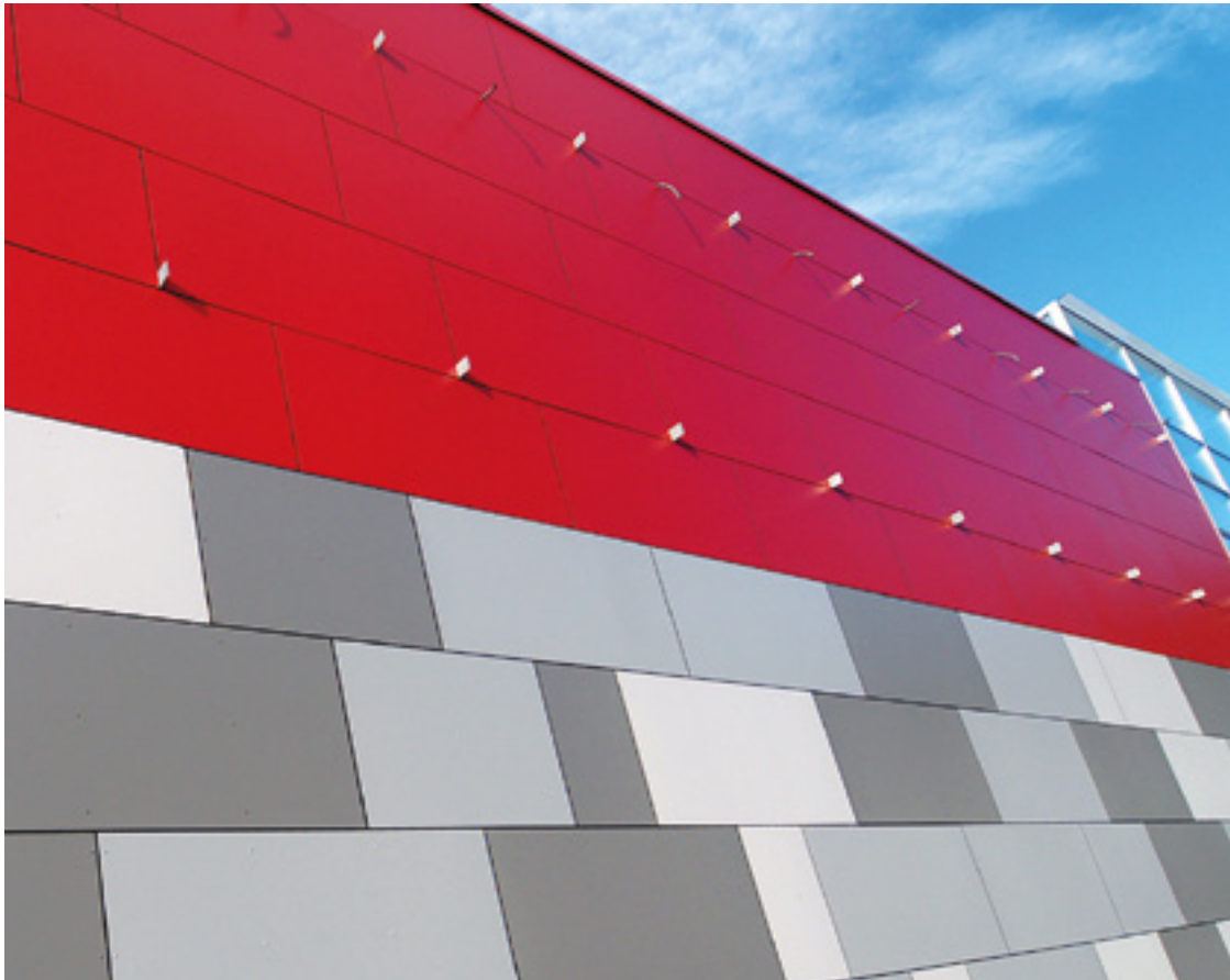
Designer Outlet Brennero/ Ahrntaler Fassaden-Balkone
